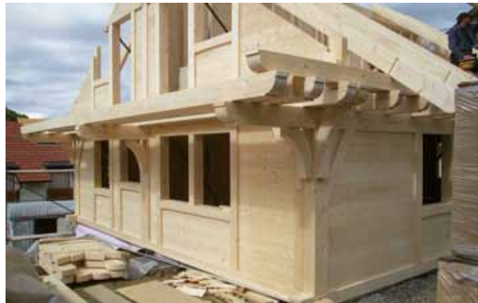
Verbindung mit Spatzenbrettnuten am Sparren; Weingärtner Holzbau. Joining with grooves at the rafter; Weingärtner Holzbau.
