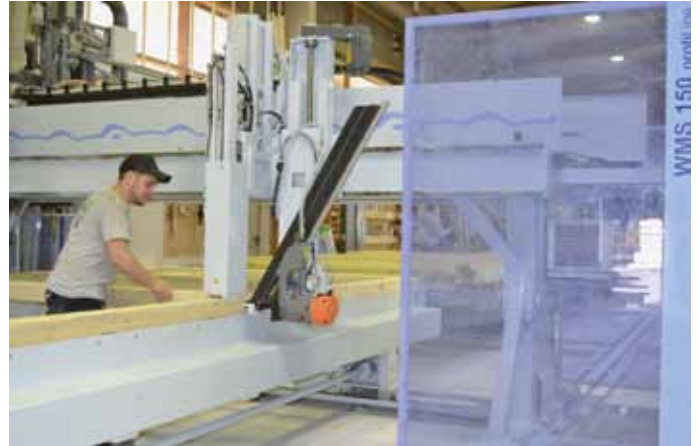
Teilautomatische Riegelwerkserstellung mit der Multifunktionsbrücke. Semi-automatic frame work production with the multifunction bridge.
